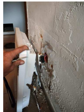
Infiltration eau depuis des mois Montorlin (Biens du revers)
